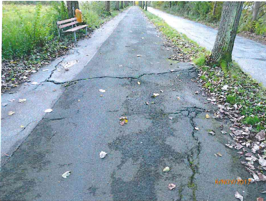
Wegeschäden durch oberflächennahe Wurzeln, Foto Stadt Heiligenhaus
